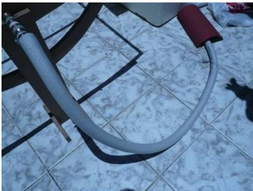
Fig.14. 18 – Mangueira com isolante térmico.
