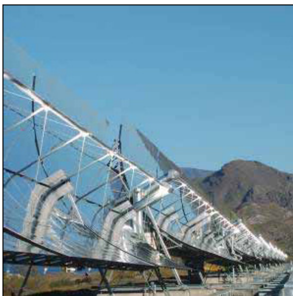
Fig. 7. 1 – Coletores de calha parabólica.
