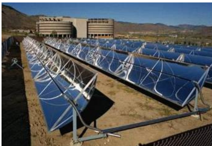
Fig. 6. 3 – Coletores de calha parabólica.
