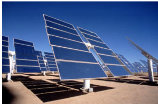
Fig. 6. 1 – “Heliostats” do sistema de torre de energia.
